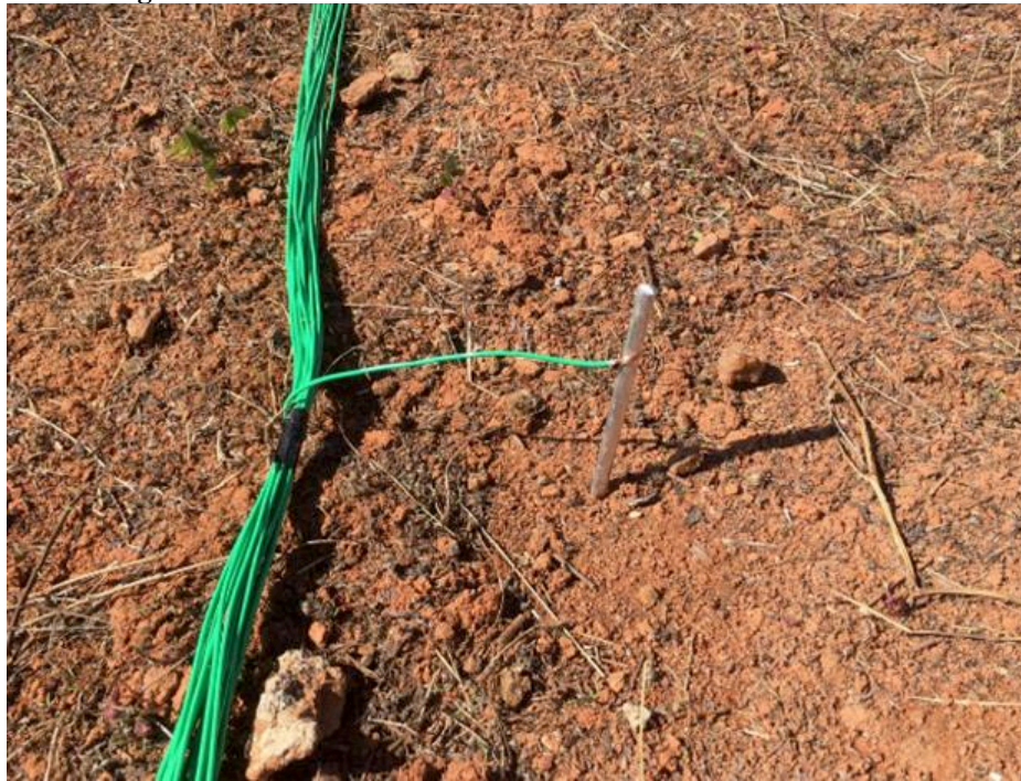
Figura 30 – Chicote de cabos devidamente conectado no eletrodo
