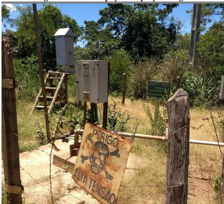
Figura 25 – Foto de poço de captação de água
