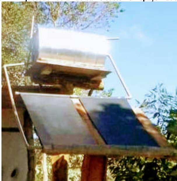
Figura 11 - Aquecedor Solar de baixo custo no Espaço Educacional Contraponto
