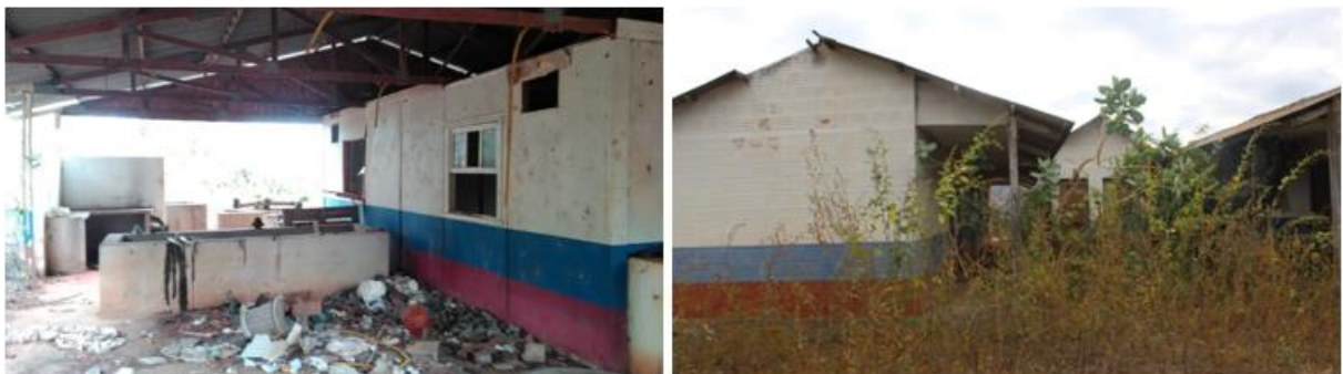
Figura 9 – Estruturas abandonadas após finalização da construção da barragem
