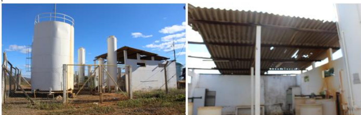
Figura 11 – Estação de tratamento de água – Agrovila 2
