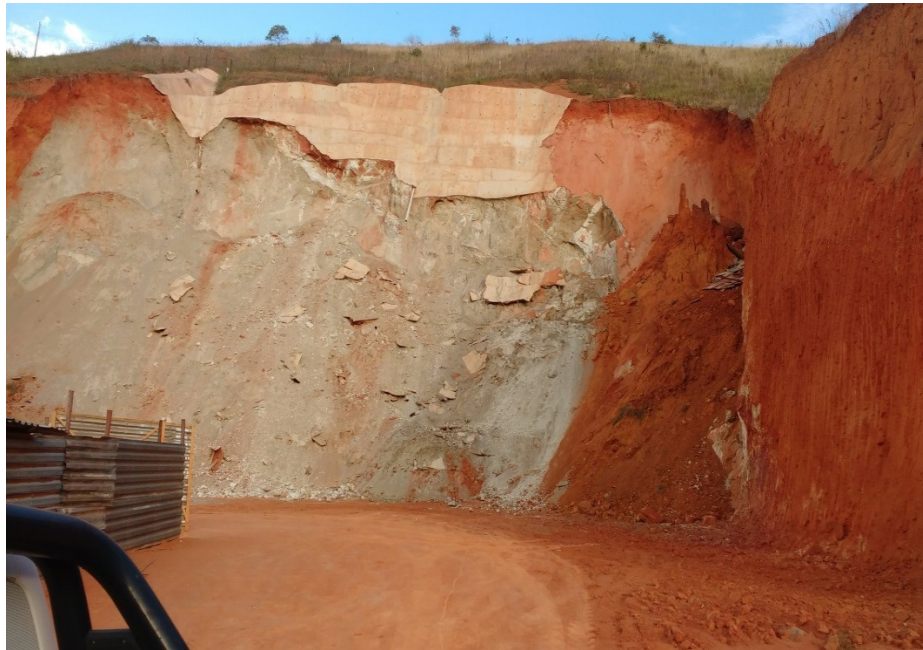
Figura 18 – Fotografia de Deslizamento de Solo Devido a Contenção Irregular de Encosta feita às Margens da BR 101 – entrada da cidade de Teófilo Otoni (Arquivo Pessoal, 2016).
