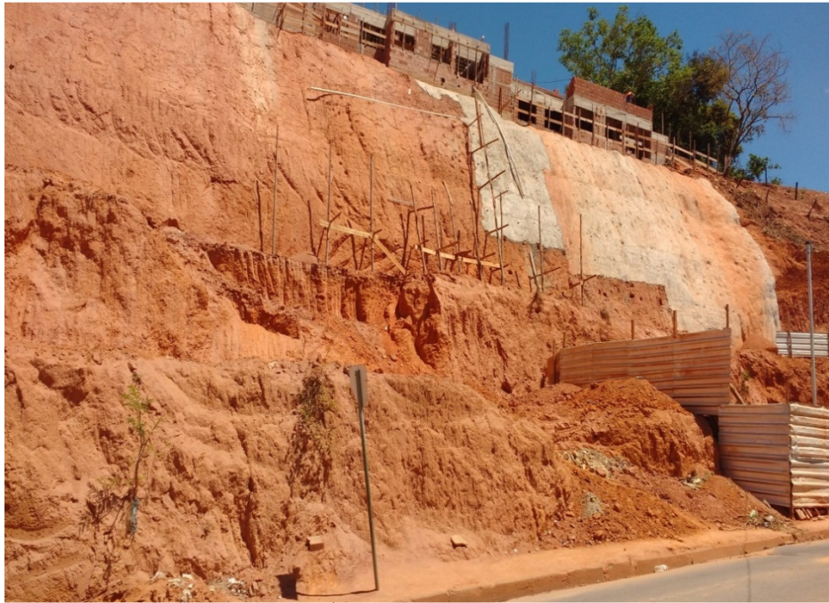
Figura 17 – Fotografia de Construção em Área de Acentuado Declive e Solo Instável, com Supressão de Vegetação e sem Adoção de Medidas Estruturais Preventivas (Arquivo Pessoal, 2016).
