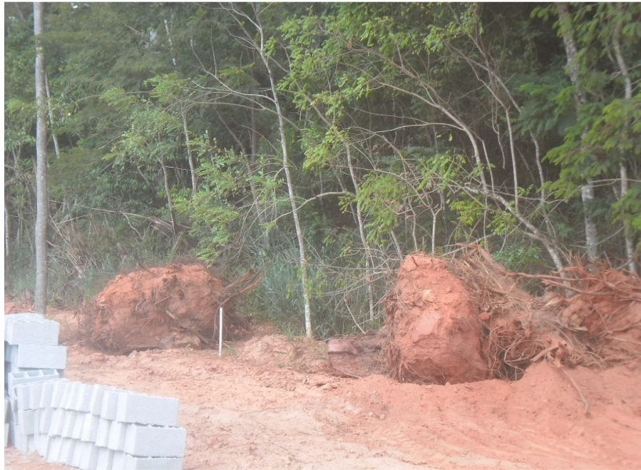
Figura 13 – Fotografia de Intervenção em Área de Preservação Permanente com Destoca de Árvores sem Autorização Ambiental no Bairro Laranjeiras (SEMAD, 2015 - Arquivo Institucional).
